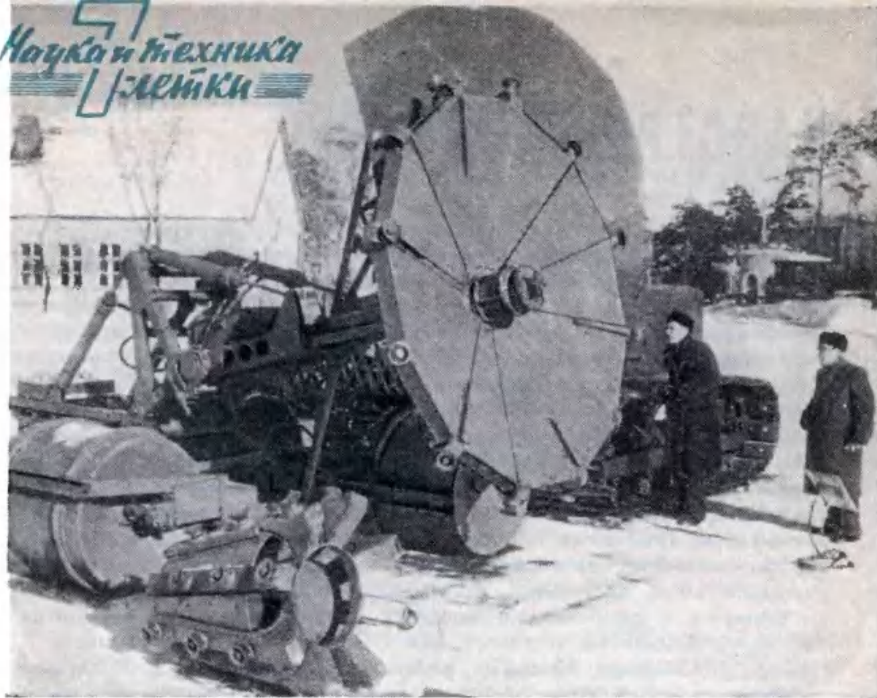
Тяжел, малопроизводителен ручной труд землекопа. На помощь человеку и здесь пришла техника. Машина, которую вы видите на фото, предназначена для рытья осушительных канав. Эта дисковая канавная машина непрерывного действия «ДМК-3» работает в паре с трактором «С-100Б». Скорость ее передвижения 155—355 м/час, глубина образующейся канавы 1200 мм. «ДМК-3» создана коллективом Калининского филиала Всесоюзного научно-исследовательского института торфяной промышленности.
